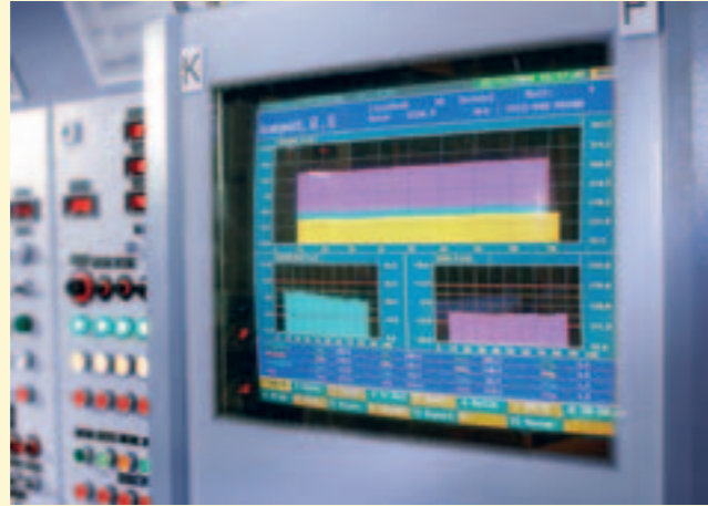
Modernissimi strumenti di controllo garantiscono massimi standard di qualità
